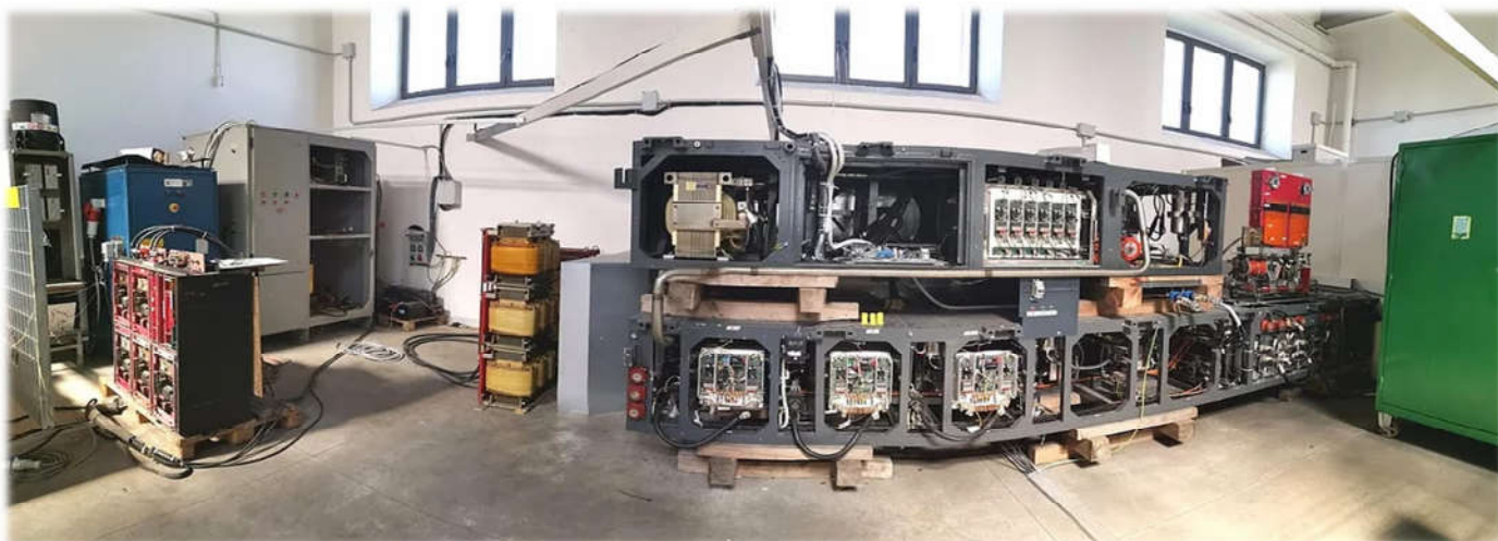
Sala prove elettriche di potenza SORIFER
